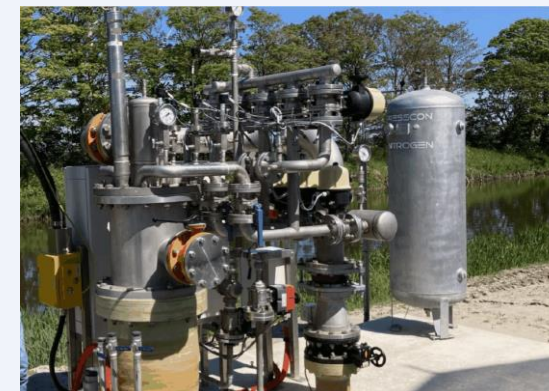
Centraal: Pompinstallatie voor de HT-ATES demo Middenmeer (IF Technology)
