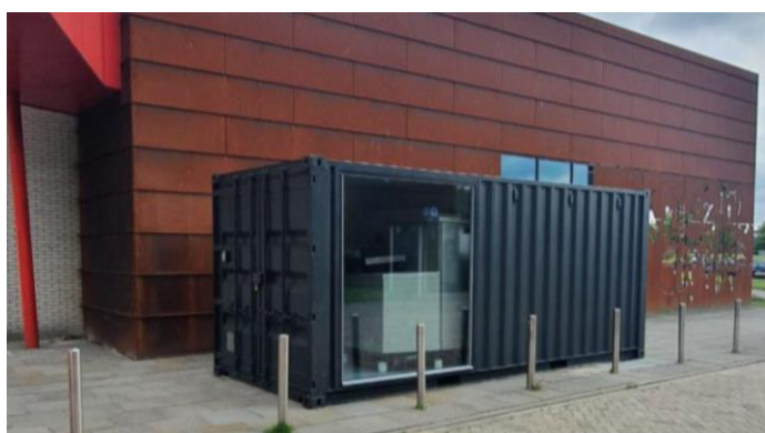
Figuur 5-2 weergave van biovergister in buitenopstelling
