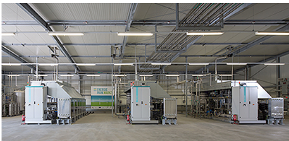
Fig. 25 Energiepark Mainz, de tot nu toe grootste (6 MW) PEM-elektrolyse-opstelling (bron Siemens)
