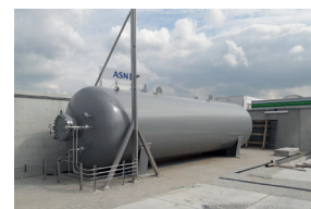
Liggende opslagtank 80 bar (Kerckhof)
