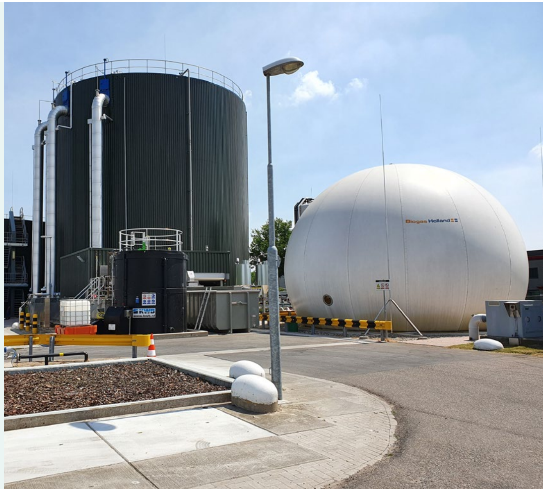
13 Slibgisting en biogasinstallatie op RWZI Tiel
