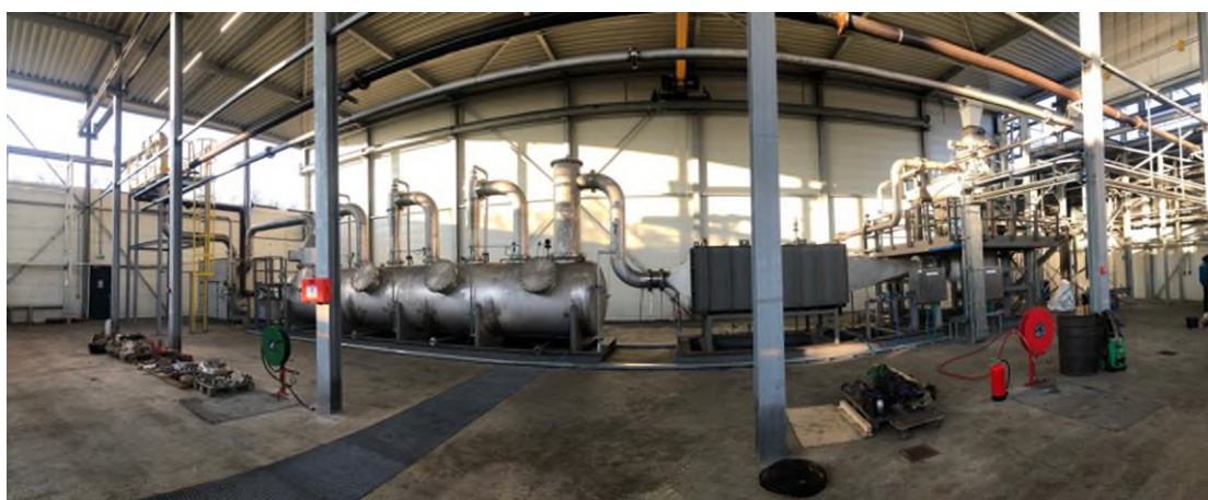
Figuur 7: Vergassingsinstallatie Bio Energy Netherlands B.V. in de Amsterdamse haven.
